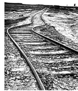
Деформация рельсового пути.
